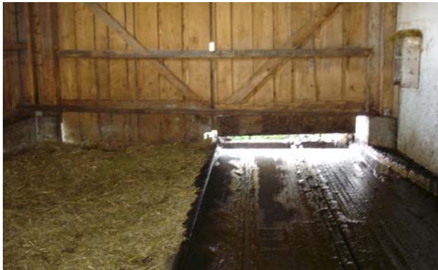
Abb. 3: Der Abwurfschacht kann eine Gefahrenquelle darstellen
